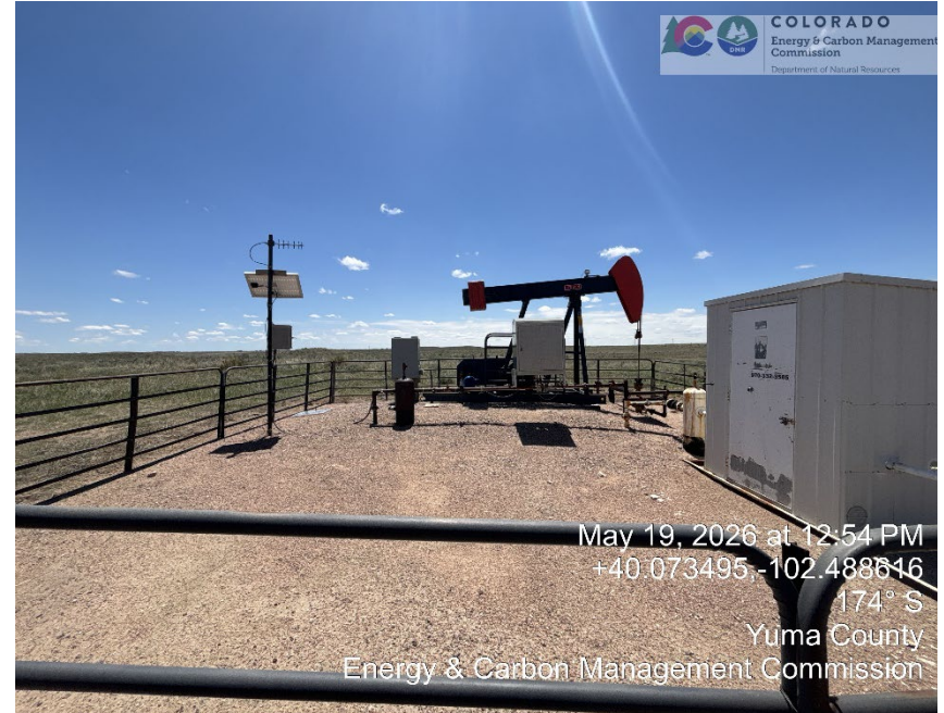
Meter run and PU
