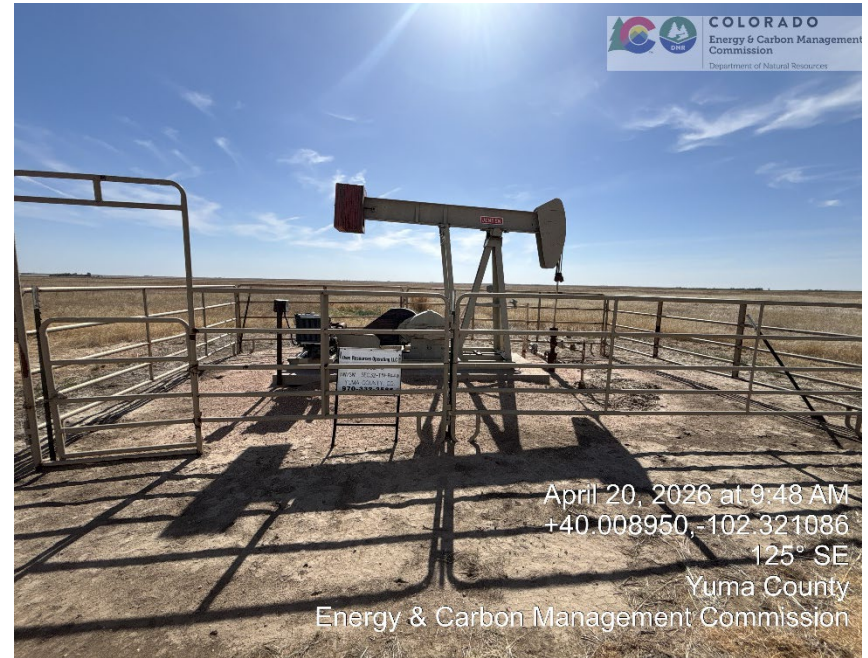
PU and Wellhead
