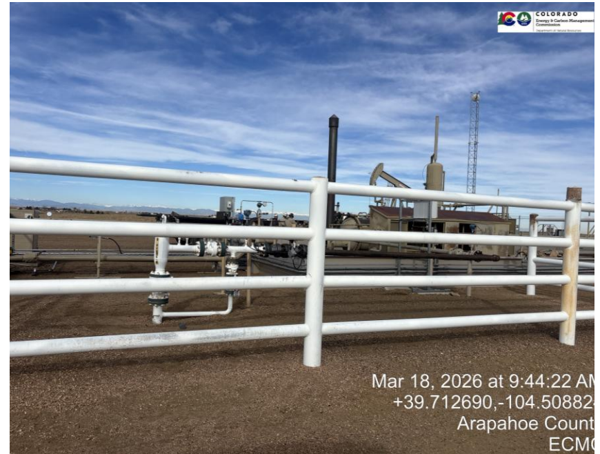
Pic 4 Separator ECD
