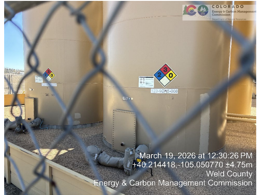
Condensate tank placards
