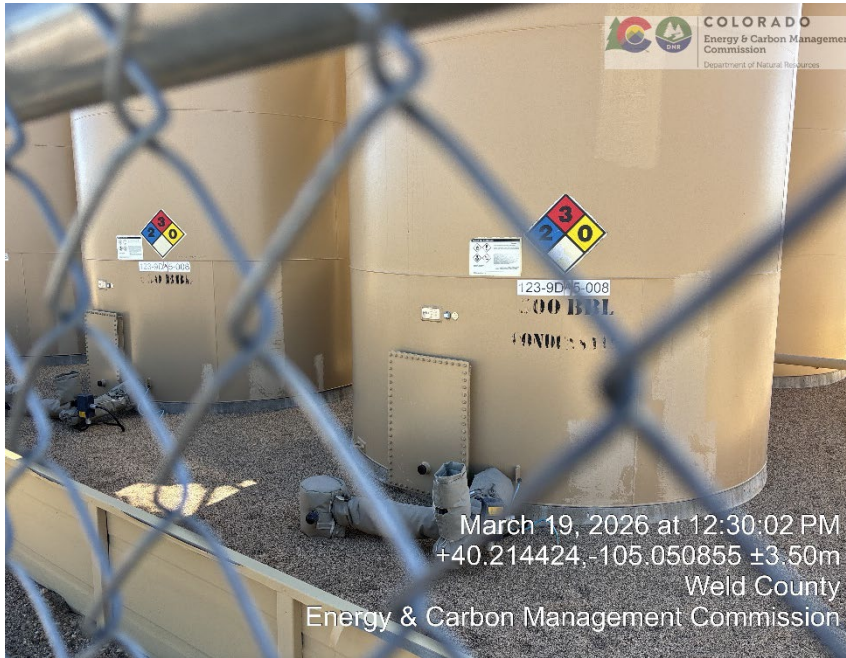
Condensate tank placards
