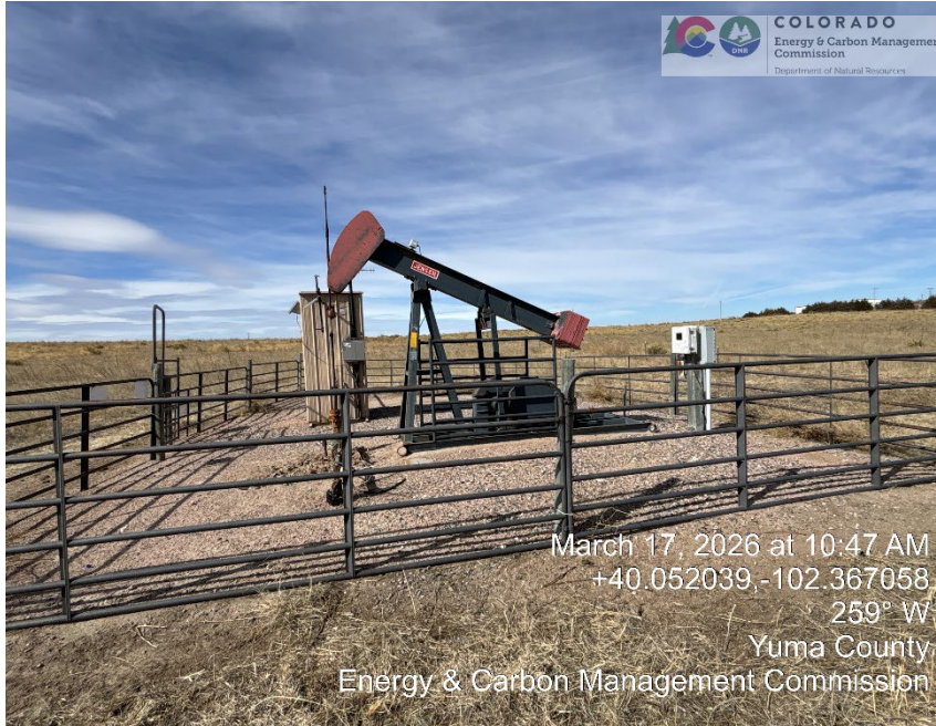
Wellhead and PU
