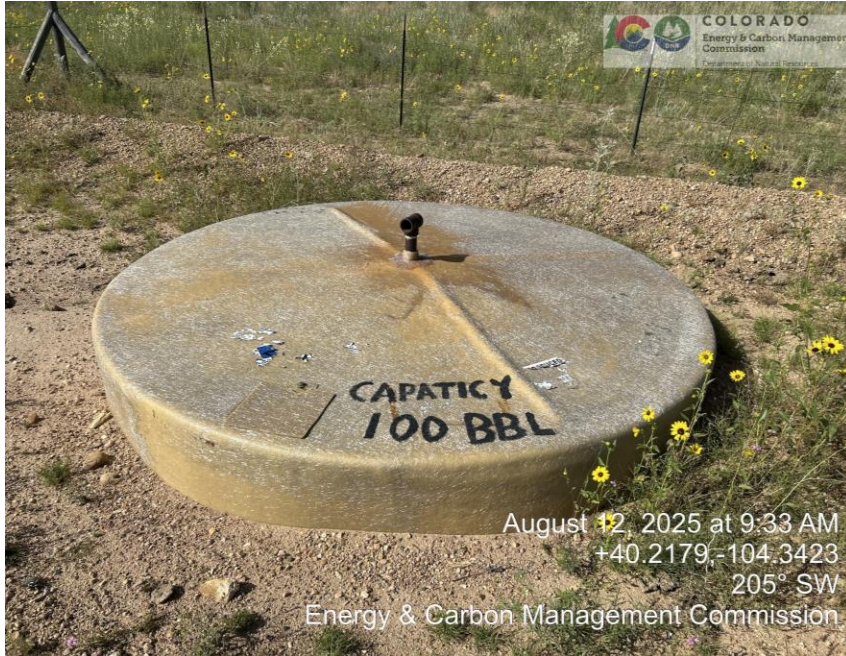
Missing NFPA Placard
