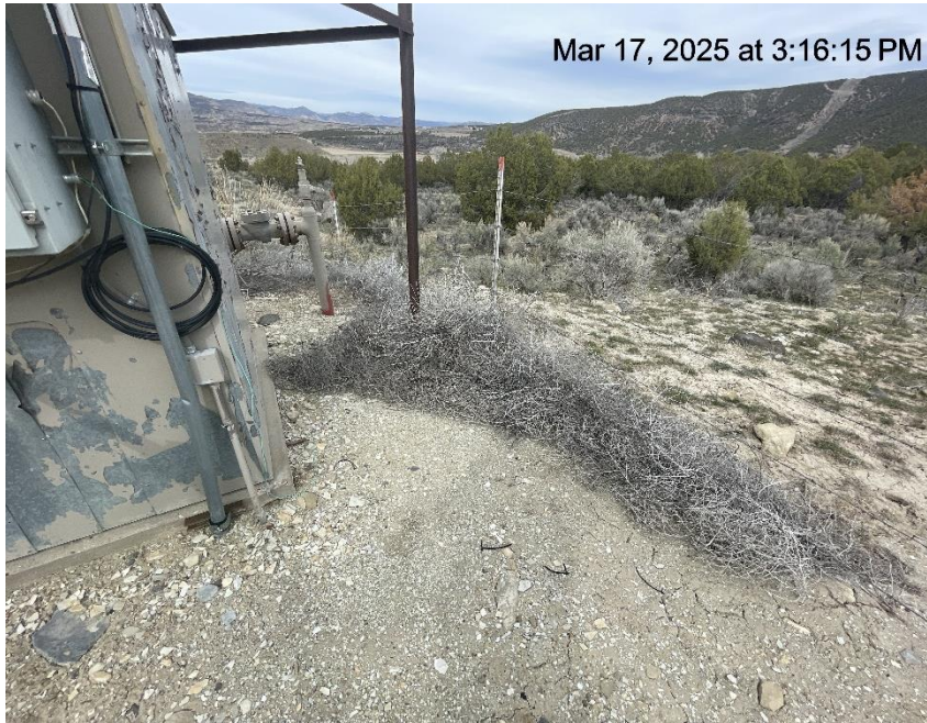
Photo # 4936 Dead weeds/debris
