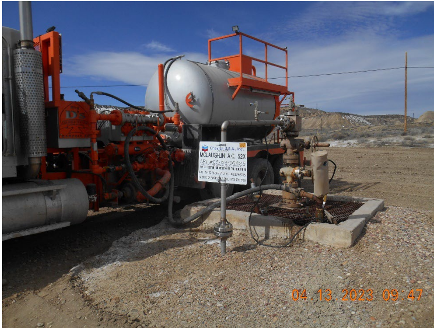
Injection wellhead during MIT
