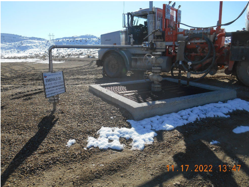
Injection wellhead during MIT
