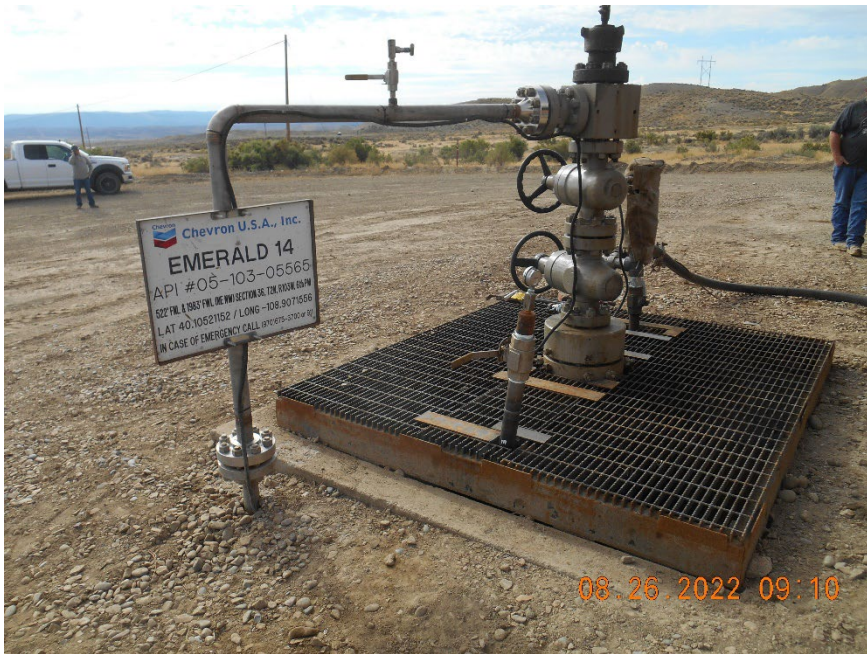
Injection wellhead during MIT
