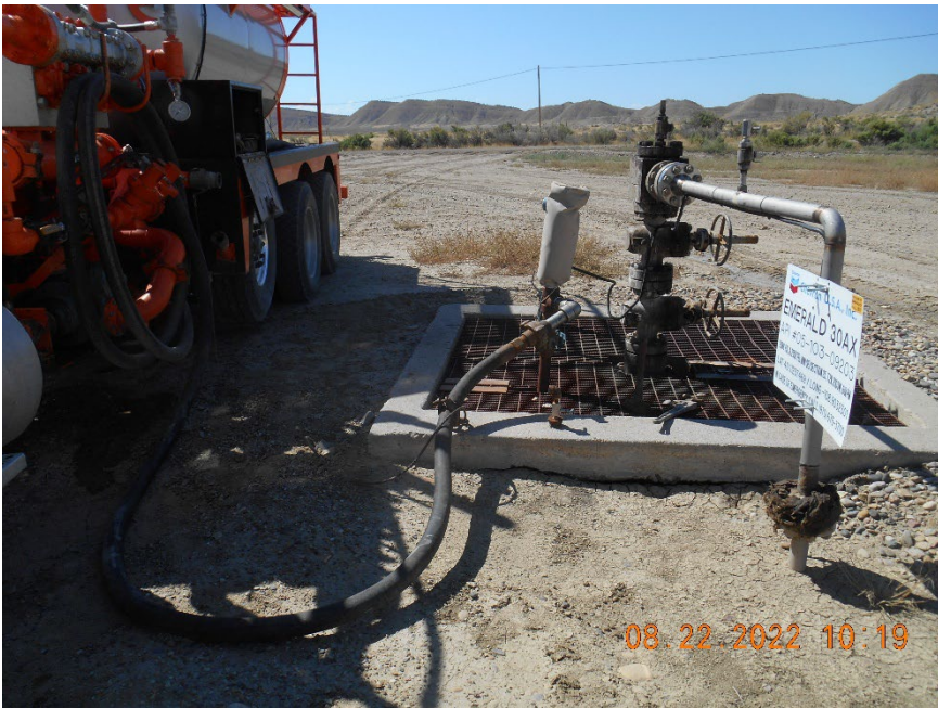
Injection wellhead during MIT
