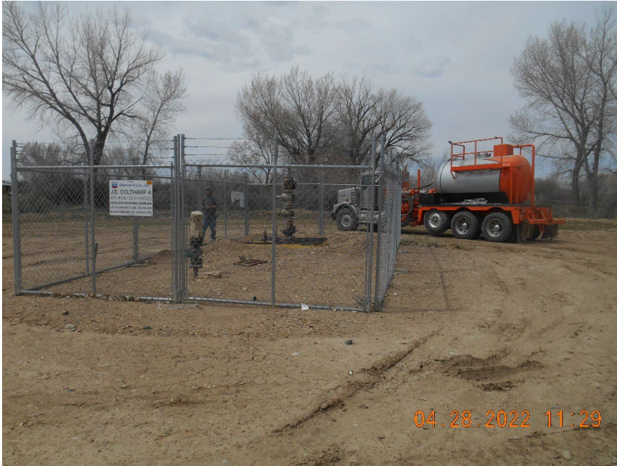
Injection wellhead during MIT
