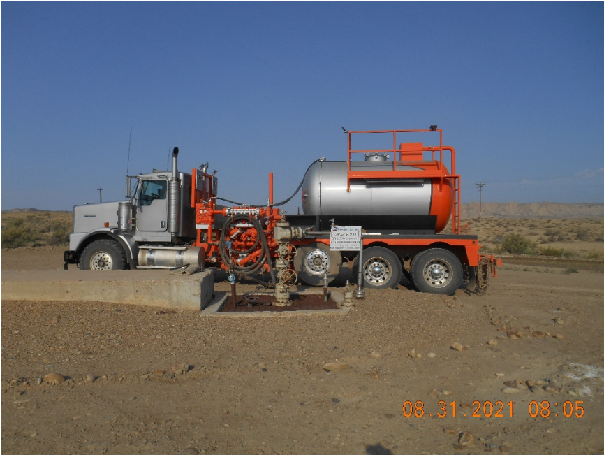
Injection wellhead during MIT
