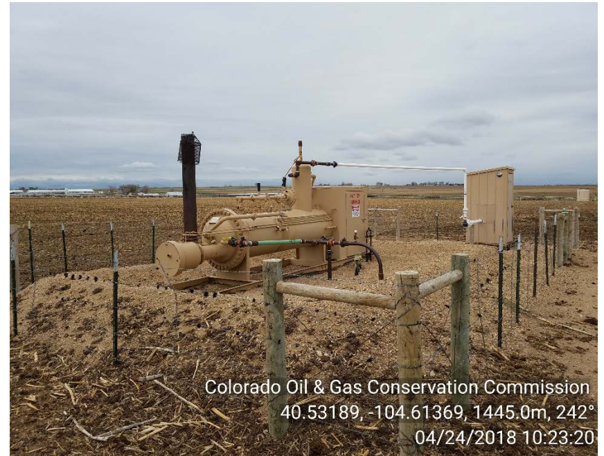
Separator & Meter Run
