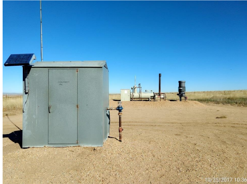
Meter Run, Separator, & ECD
